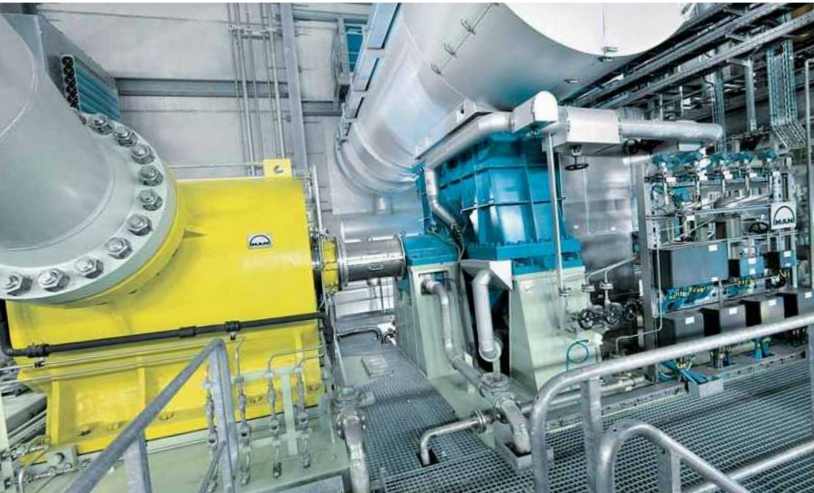
Pipeline-Verdichter RV080 und Dampfturbine DK 63/130, Antriebsleistung: 22 MW
